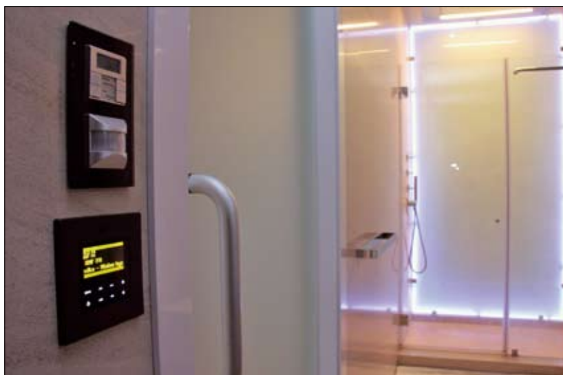
Fot. 1 | Panele sterujące systemem EIB/KNX wraz z czujnikiem ruchu firmy Schneider i systemem audio firmy NuVo, zdjęcie z archiwum firmy IRA-Inteligentne Rozwiązania Automatyki
